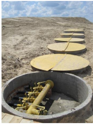
Рис.7. Ряд колекторів в бетонному колодязі.
