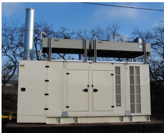
Рис.9. Зовнішній вигляд КГУ в контейнері
